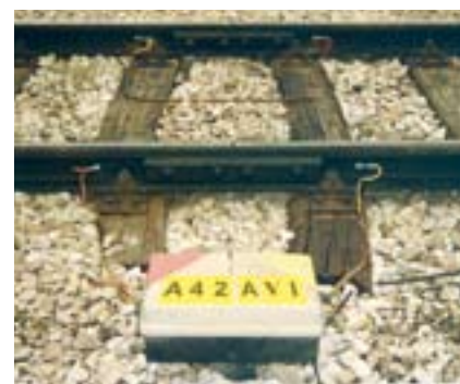
Cajas de circuitos de binario
