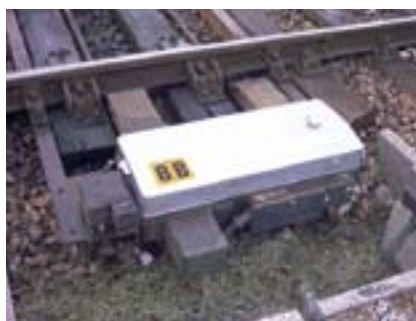
Cajas de maniobras de desvíos
