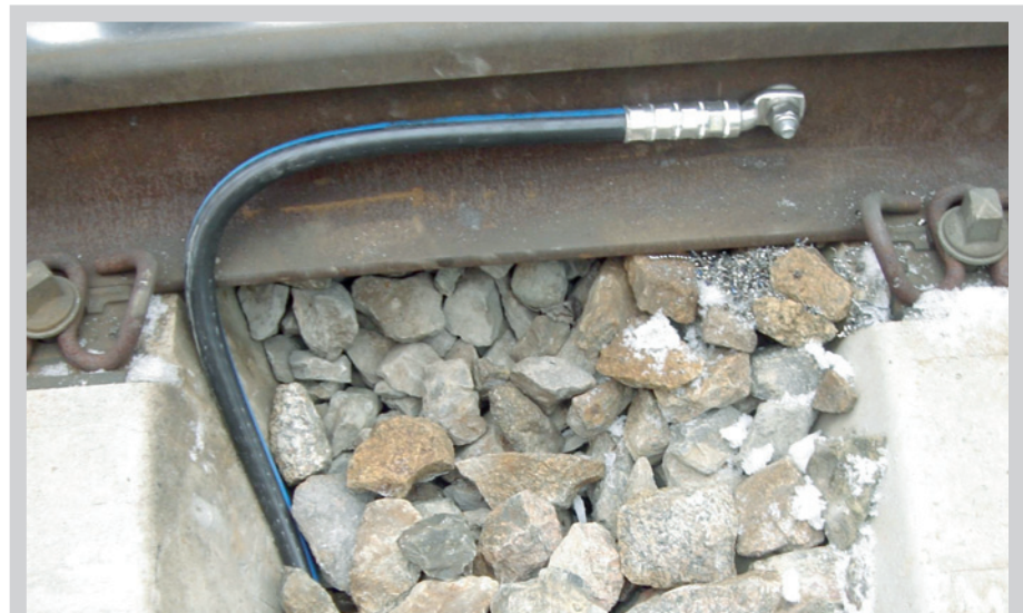
Bild 1: Erdseil in isolierter Ausführung am Schienenfuß verschraubt
